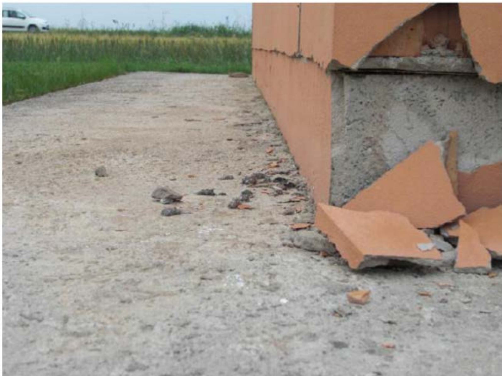
Ferrara 20 Maggio 2012. Conseguenze dell'inserimento alla base della parete di una guaina tagliamuro contro l'umidità di risalita.
